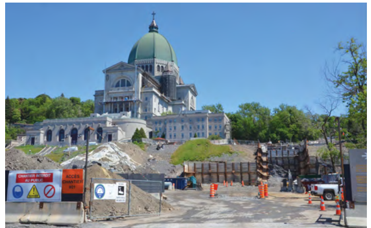
Un vaste chantier laisse entrevoir l'emplacement du futur édifice qui sera accessible dès l'entrée sur le site. Photo : André Charron, c.s.c.
